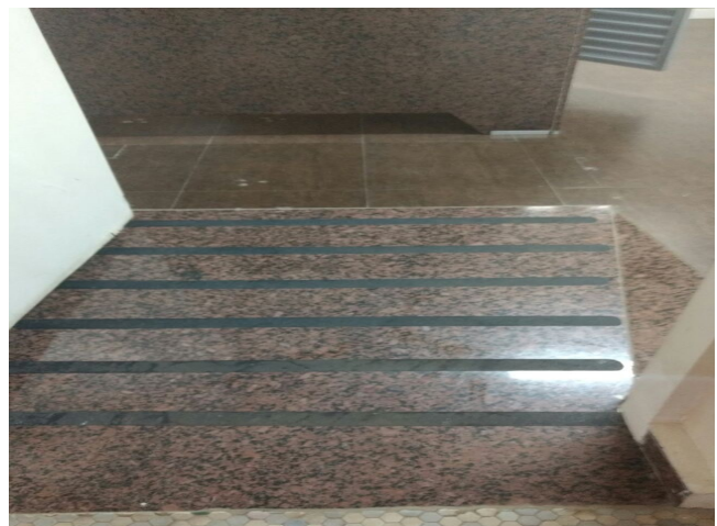
Faixas Antiderrapantes dos Banheiros
