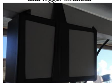
Figura 13 – Caixa de medição com data logger instalada
