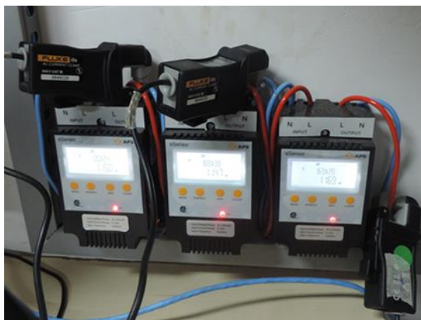
Figura 16 - Conexão dos clamp de corrente
