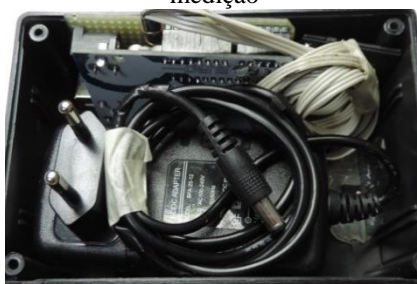
Figura 12 – Data logger na caixa de medição
