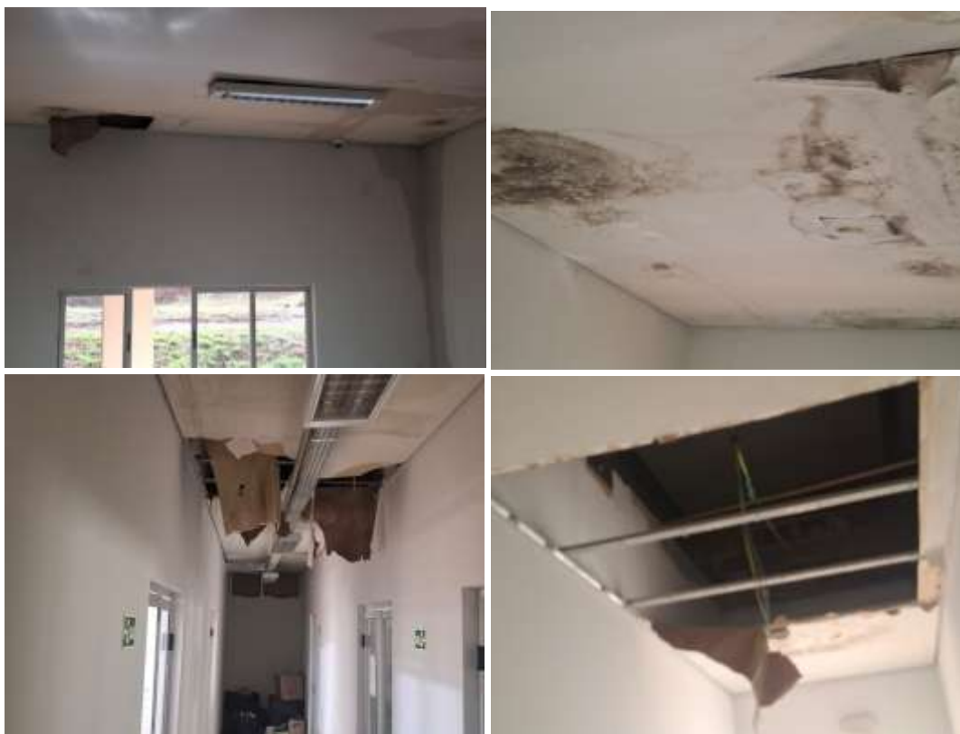
Figura 1 – Fotos do forro do teto do restaurante estudantil, antes dos reparos.
