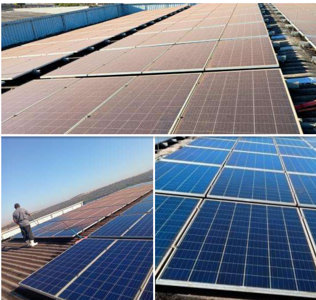
Figura 12 – Limpeza das placas fotovoltaicas.
